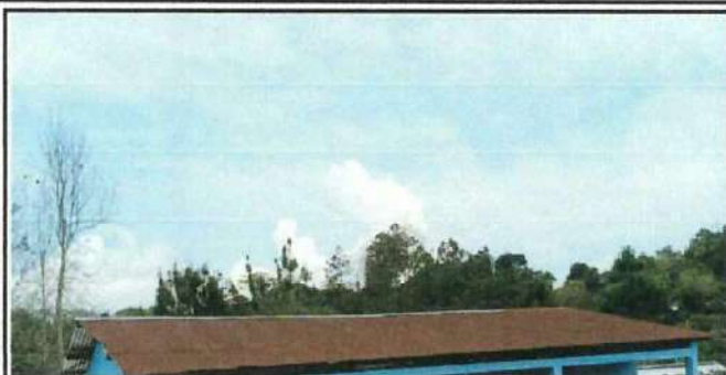
Foto 1: CUBIERTA DE LAMINA: se necesita cambiar las láminas por láminas troqueladas.
