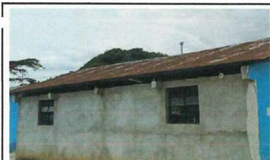
Foto 5 se necesita cambio y ampliación de ventanas adecuadas para un aula escolar para mejorara ventilación, tanto por delante como atrás.
