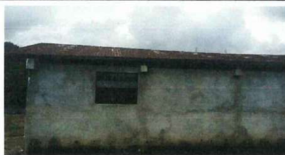
Foto 10: altura de pared: ademas la altura no es el adecuado considerando que es area de calor, se sofa en el aula, por ende es incomodo para los niños.
