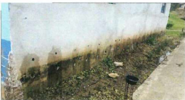
Foto 9: pared: rehabilitación de pared, el block se desborrona por la antigüedad que tiene y pone en riesgo la seguridad de los niños de parvulos.
